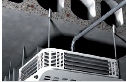
Klimageräte in Spannbeton-Hohldeckenplatten
