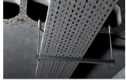
Kabeltragsysteme in Spannbeton-Hohldecken
