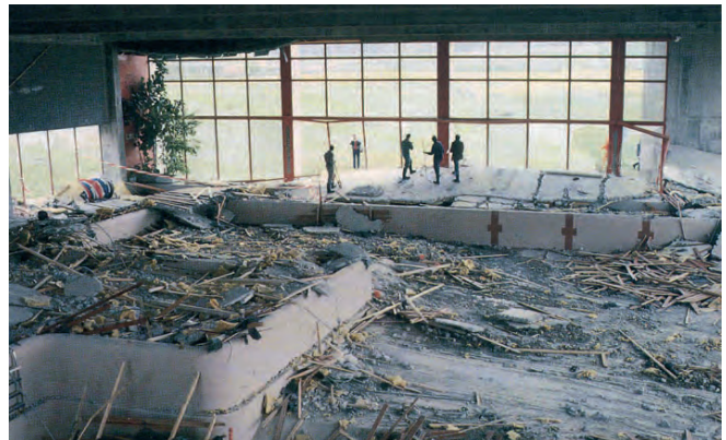
1985 versagte die abgehängte Betondecke eines Hallenbades im schweizerischen Uster. Die Aufhängungen der Decke aus nichtrostendem Stahl A2 zeigten rein äußerlich keinerlei Mängel, waren jedoch innerlich teilweise vollkommen durch Spannungsrisskorrosion zerstört.
