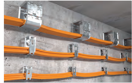
Kabelbefestigung an der Wand
