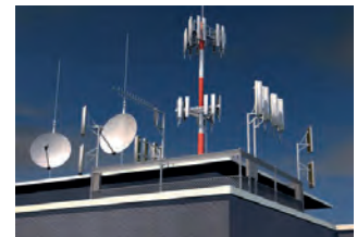
Antennen und Masten
