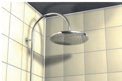
Verfugungen im Sanitärbereich
